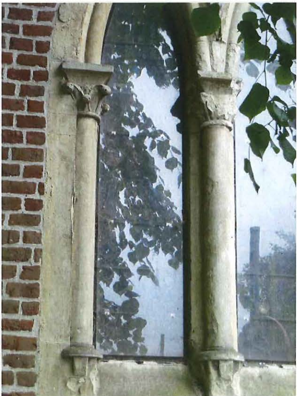
Foto 29. Oostelijke zijgevel van de Milanenkapel: detail gekoppelde lancetvensters met zuilen en kapiteeltjes (21/06/2013)
