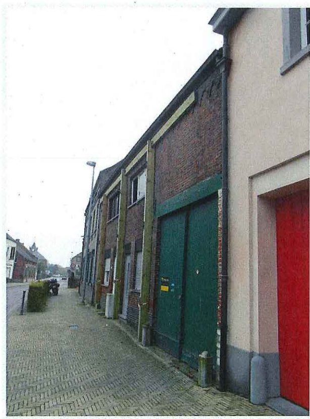
Foto 34: Bijgebouw burgerwoning, Grote Baan 59-61, voorgevel gestut
