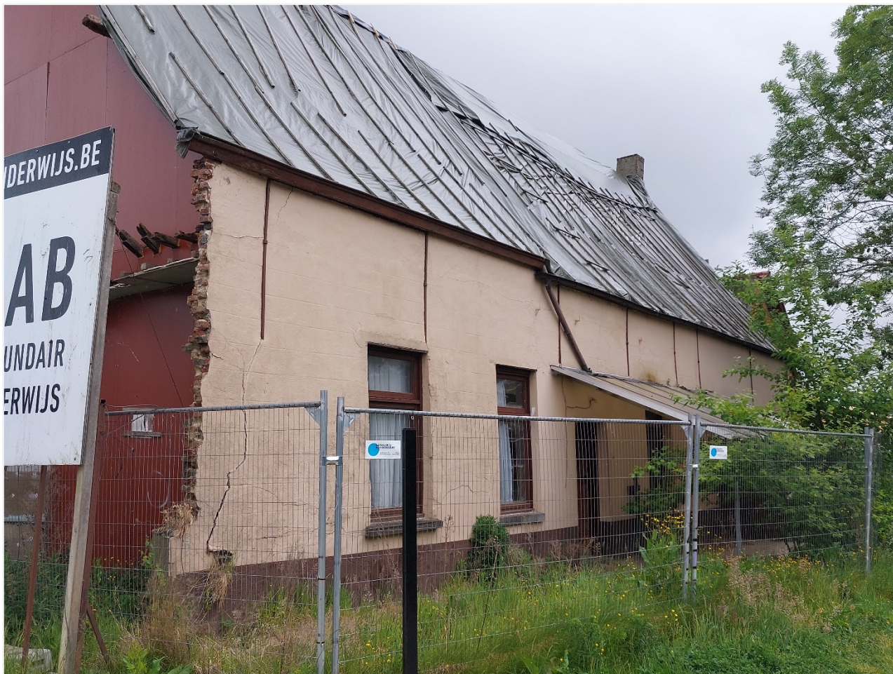
Foto 18: Hoeve, gedateerd 1663, met omgeving. Zicht op achtergevel en op ingestorte noordelijke zijgevel met afgescheurd metselwerk.
