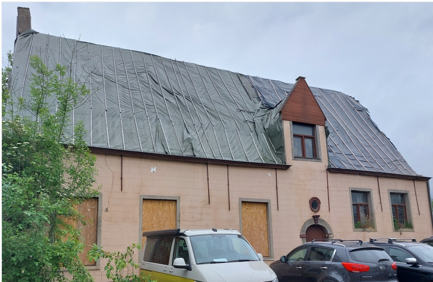
Foto 7: Hoeve, gedateerd 1663, met omgeving. Zicht op erfgevel van boerenhuis, met nooddak en deels tegen vandalisme beveiligde vensters..
