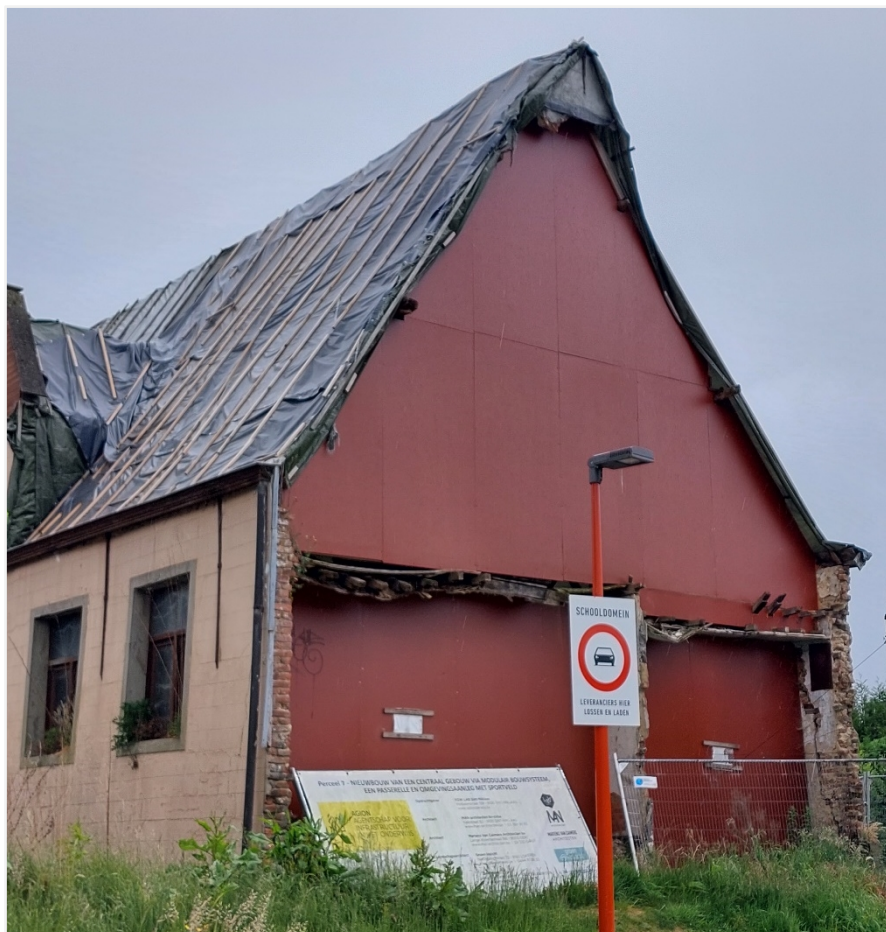
Foto 17: Hoeve, gedateerd 1663, met omgeving. Zicht op ingestorte noordelijke zijgevel, met afgescheurd metselwerk en nooddichting.
