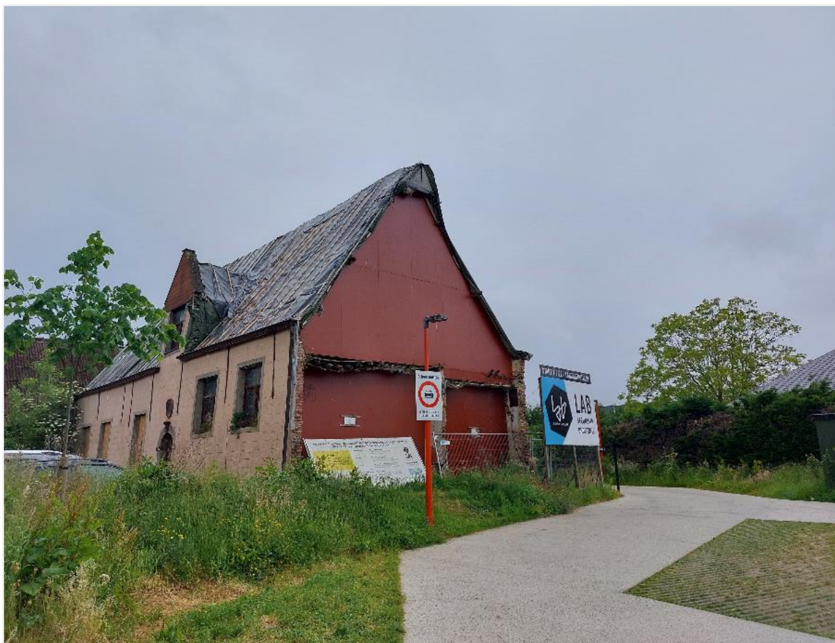
Foto 5: Hoeve, gedateerd 1663, met omgeving. Zicht op boerenhuis met nooddak en ingestorte noordelijke zijgevel. Vooraan toegangsweg naar achterliggende school.
