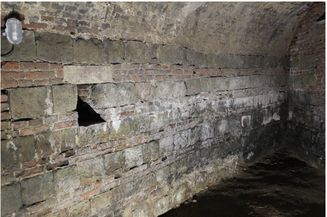
Foto 33: noordoostelijke wand van de zuidoostelijke schietkamer van de benedenverdieping van het rondeel. Muur in speklagen van Lincient tufsteen en baksteen, schietgat en bakstenen tongewelf.
