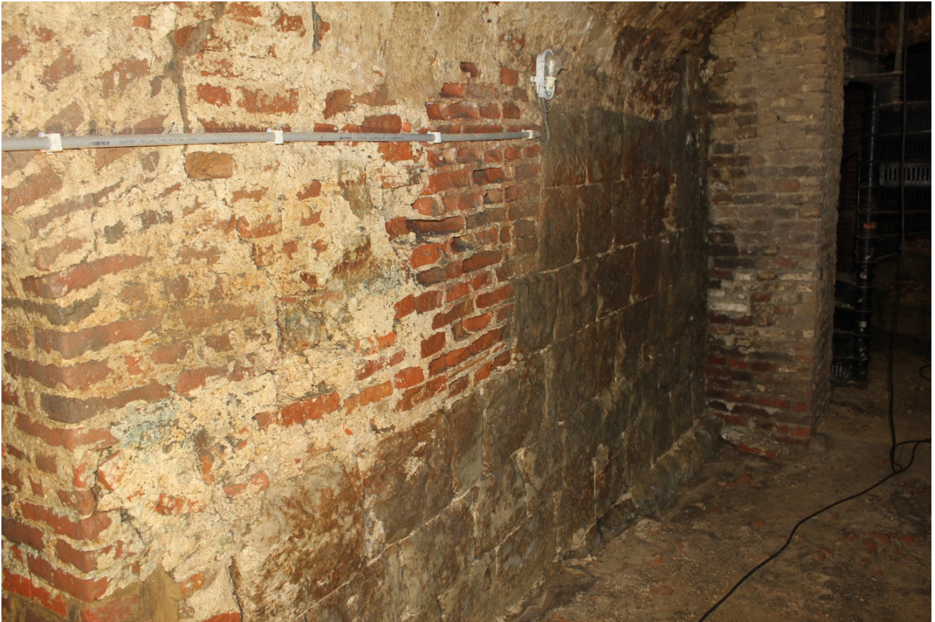
Foto 7: de grote zaal met de oostelijke wand van het poortgebouw, ter hoogte van de benedenverdieping en gezien vanuit het zuiden. Op het jongere baksteenmetselwerk volgt het oorspronkelijke metselwerk in Lincenstufsteen uit de 12de eeuw.
