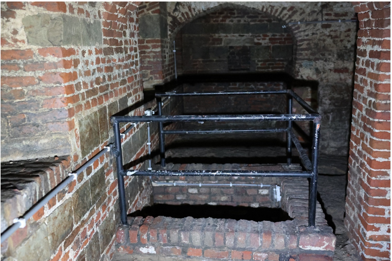
Foto 37: opening naar de kanalisaties in de grote zaal (benedenverdieping).
