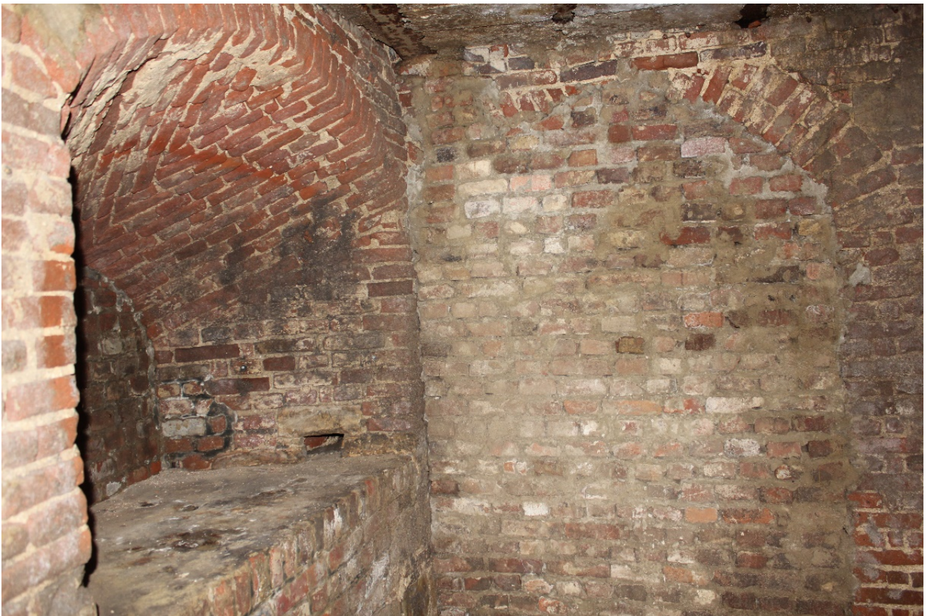
Foto 13: kanogat in de noordoostelijke schietkamer van de bovenverdieping van het rondeel, en latere afsluitmuur.
