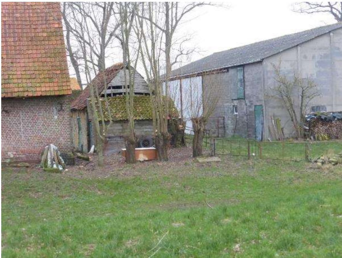
Foto 64: de oostelijke zijgevel van de jaarlingenstal op het neerhof bewaart in het gevelveld stijl- en regelwerk met horizontale plankenbeschiëting (plaatsbezoek Onroerend Erfgoed 17.01.2024).
