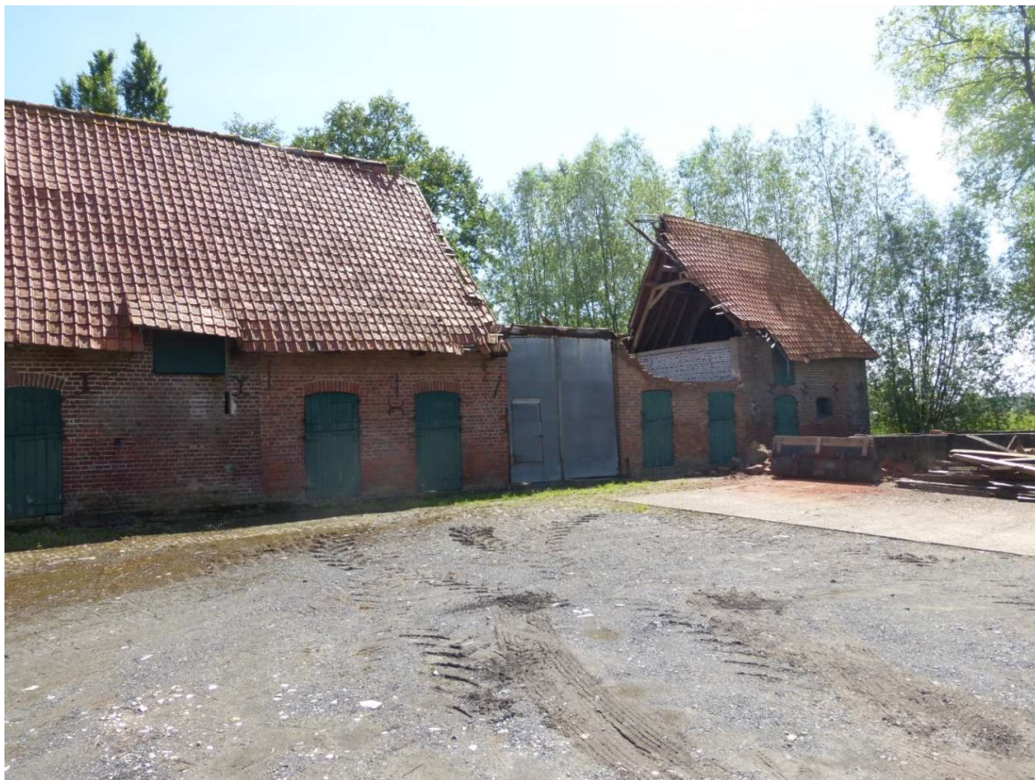
Foto 59: de dwarsschuur na de gedeeltelijke instorting van 3 april 2024. Vooral het middendeel ter hoogte van des schuurdoorrit liep veel schade op. De eigenlijke poortvleugels (hoger dan de algemene dakoverstek en ter bescherming met recent beslag in metaalplaten) liep geen zichtbare schade op (plaatsbezoek Onroerend Erfgoed 17.05.2024).
