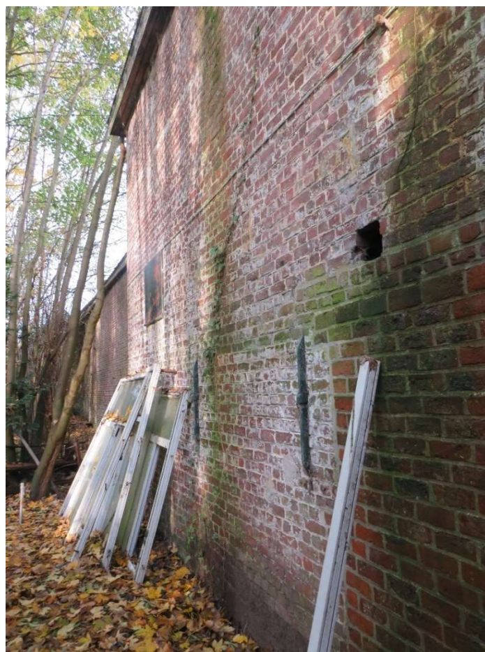
Foto 10 – Zicht vanuit het zuidoosten op de zuidgevel van het ketelhuis, de machinekamer en de kantoorruimte van de voormalige fabriek Textiles d'Ecloo © 2023 - Onroerend Erfgoed.
