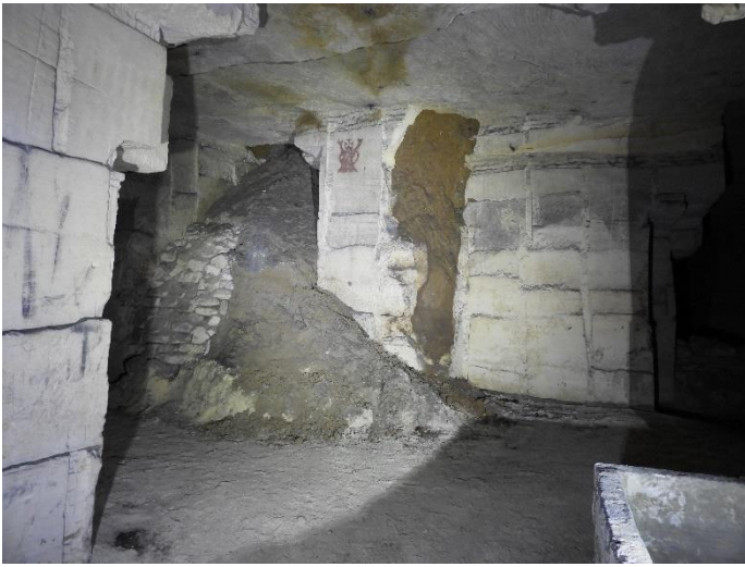
Foto 19. Zone met historische instortingen en tekening van een duiveltje, vermoedelijk om aan te geven dat het een gevaarlijke locatie is
