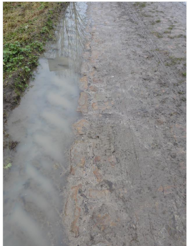
Foto 8: Kasseien en boordstenen in Tiense kwartsiet met spoorvorming.
