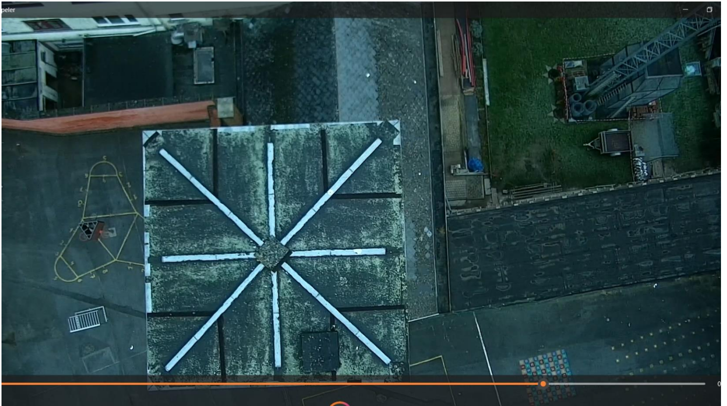
Foto 7: bijna plat roevendak. De schutterstoren is ingebouwd in het éénlaagse bakstenen volume onder zadeldak van het vroegere gildelokaal (niet in de bescherming opgenomen) (rapport Monumentenwacht, still uit dronefilm, plaatsbezoek 14.12.2022, © Monumentenwacht).
