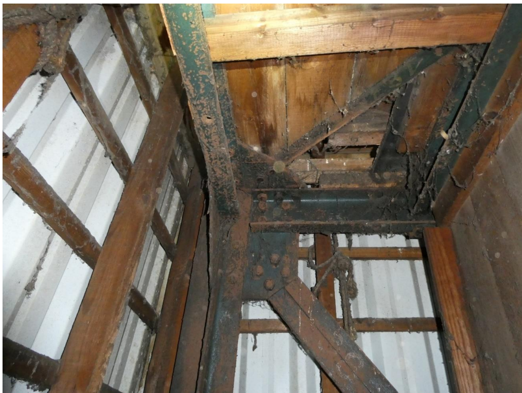
Foto 24: inspectieschacht: tussen de bovenste verdieping en de zolder is een plankenvloer geplaatst in een metalen kader (rapport Monumentenwacht, Wim Meers, plaatsbezoek 30.01.2023, © Monumentenwacht).
