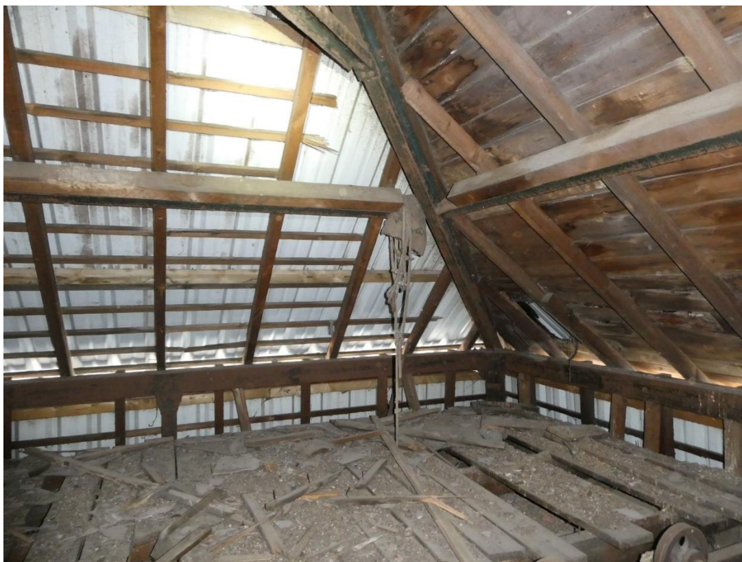
Foto 25: zolder van de schutterstoren: het piramidedak rust op omlopende metalen liggers. Het dak is opgebouwd uit metalen hoekriben met 'hanenbalken'. Houten kepers en een deels bewaarde bebording dragen de bekleding (rapport Monumentenwacht, Wim Meers, plaatsbezoek 30.01.2023, © Monumentenwacht).
