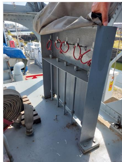
Foto 24: kast met herstellende bediening CO 2 brandbestrijding
