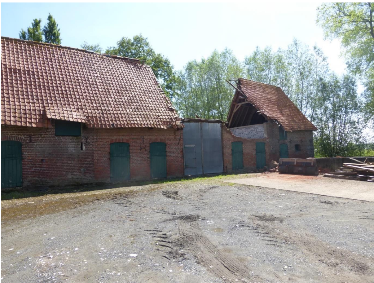
Foto 58: de dwarsschuur na de gedeeltelijke instorting van 3 april 2024. Vooral het middendeel ter hoogte van des schuurdoorrit liep veel schade op. De eigenlijke poortvleugels (hoger dan de algemene dakoverstek en ter bescherming met recent beslag in metaalplaten) liep geen zichtbare schade op (plaatsbezoek Onroerend Erfgoed 17.05.2024).
