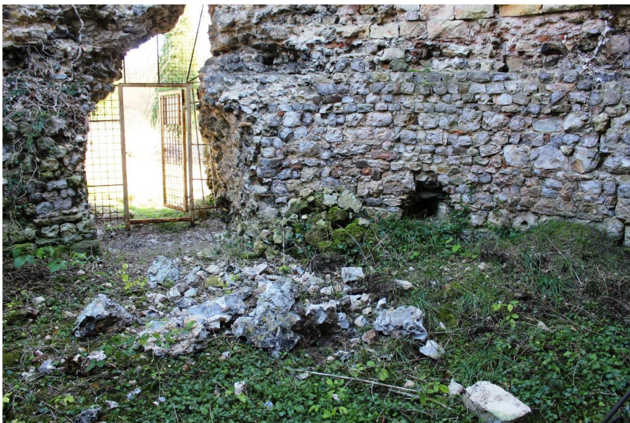
Foto 32: binnenzijde van de donjon, met metselwerk dat is neergevallen na stormweer (15 februari 2022).
