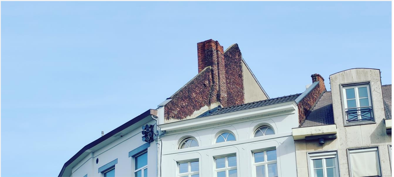
Foto 4: zijpuntgevel: sporen van dakwerken waarbij de zijpuntgevel met aandak en vlechtingen deels heropgebouwd werd
