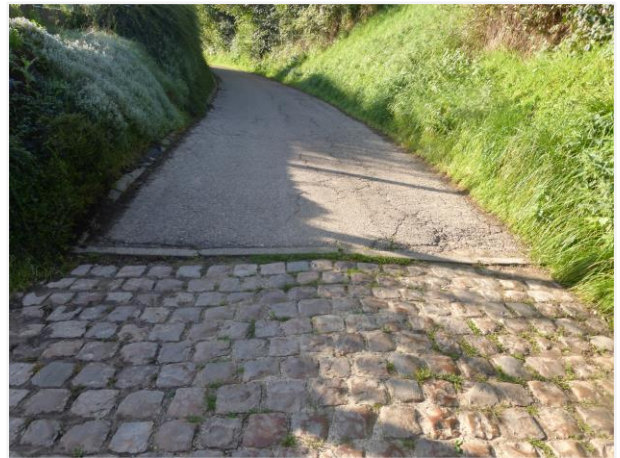
Foto 4: De overgang tussen de kasseiweg en de asfaltverharding in het zuiden.
