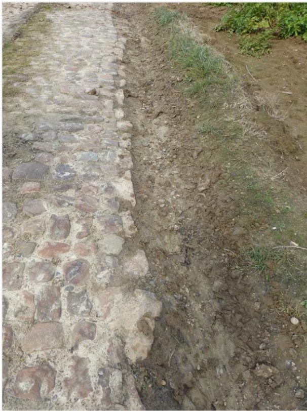
Foto 5: Spoorvorming in de bermen van de kasseiweg.
