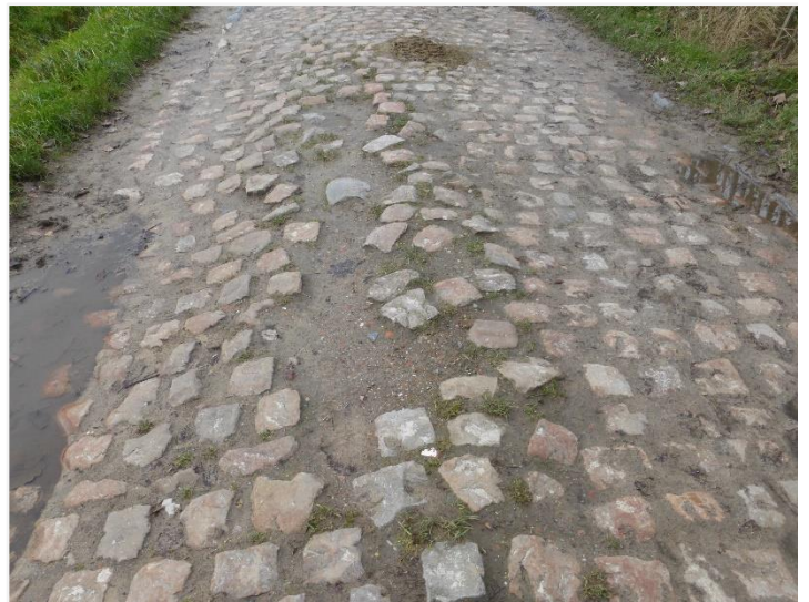
Foto 4: Zone met kasseien die uit verband zijn geraakt.
