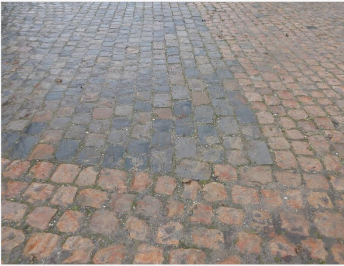
Foto 5: Kasseien in ander materiaal op het kruispunt met de Konijnenbergstraat.
