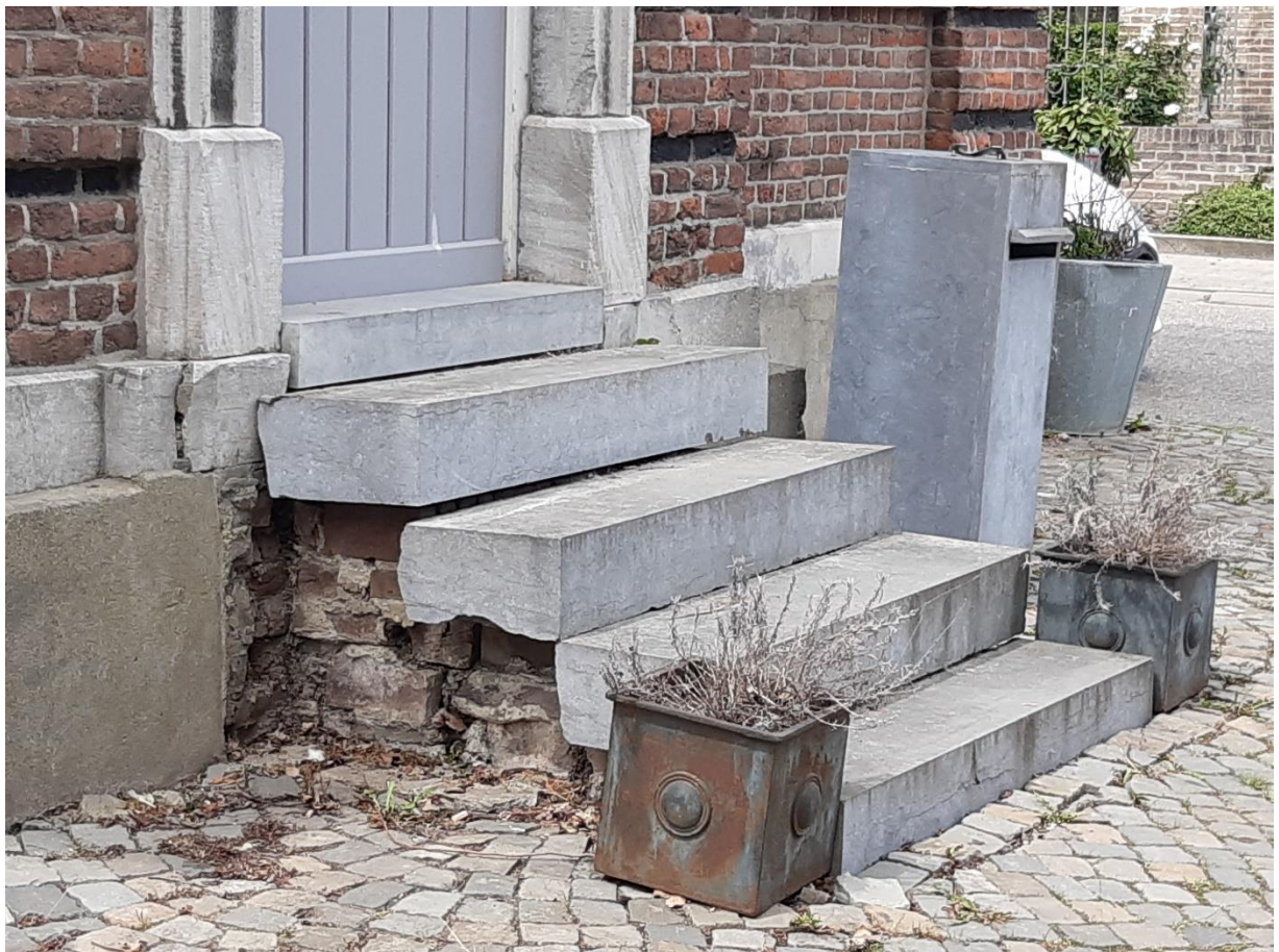
Foto 6: gewijzigde trap van de voorgevel
