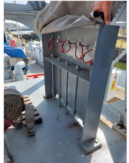
Foto 24: kast met herstelde bediening CO 2 brandbestrijding
