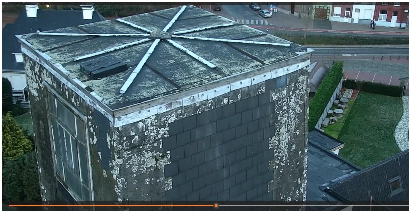
Foto 5: bijna plat roevendak met stervormige roeven en oorspronkelijk zinken dakbedekking. Het raam met venster in de westelijke top is bewaard, het dichtgemaakte raam aan de zuidzijde is nog afleesbaar aan de minder verkleurde leien. Het venster is voorzien van een grote metalen roedeverdeling (rapport Monumentenwacht, still uit dronefilm, plaatsbezoek 14.12.2022, © Monumentenwacht).
