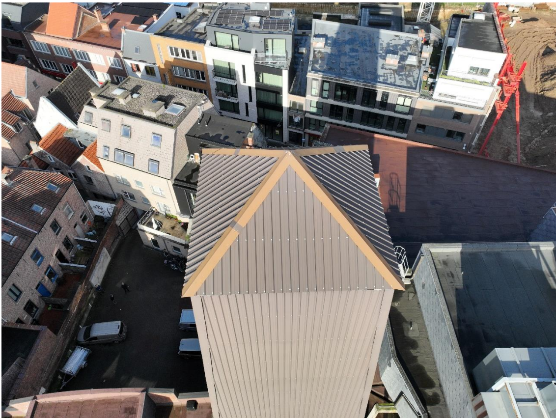
Foto 8: de toren versmalt naar boven toe en is afgedekt met een zwak hellend, licht overkragend piramidedak (rapport Monumentenwacht, dronebeeld Wim Meers, plaatsbezoek 30.01.2023, © Monumentenwacht).
