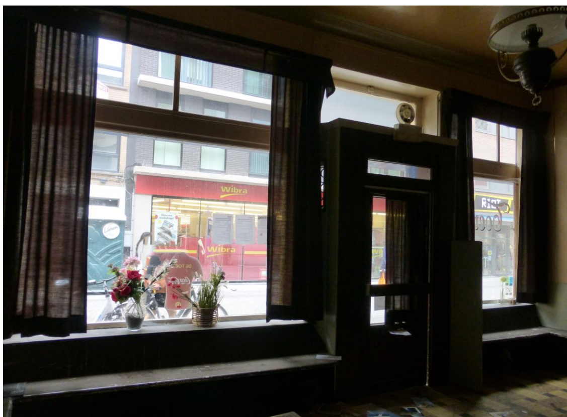
Foto 15: interieurzijde van de herbergpui. Aan de binnenzijde is het verdiepte portaal rechthoekig uitgewerkt. Boven de vensters en het portaal steekt een breed bovenlicht (plaatsbezoek Onroerend Erfgoed 16.05.2022).
