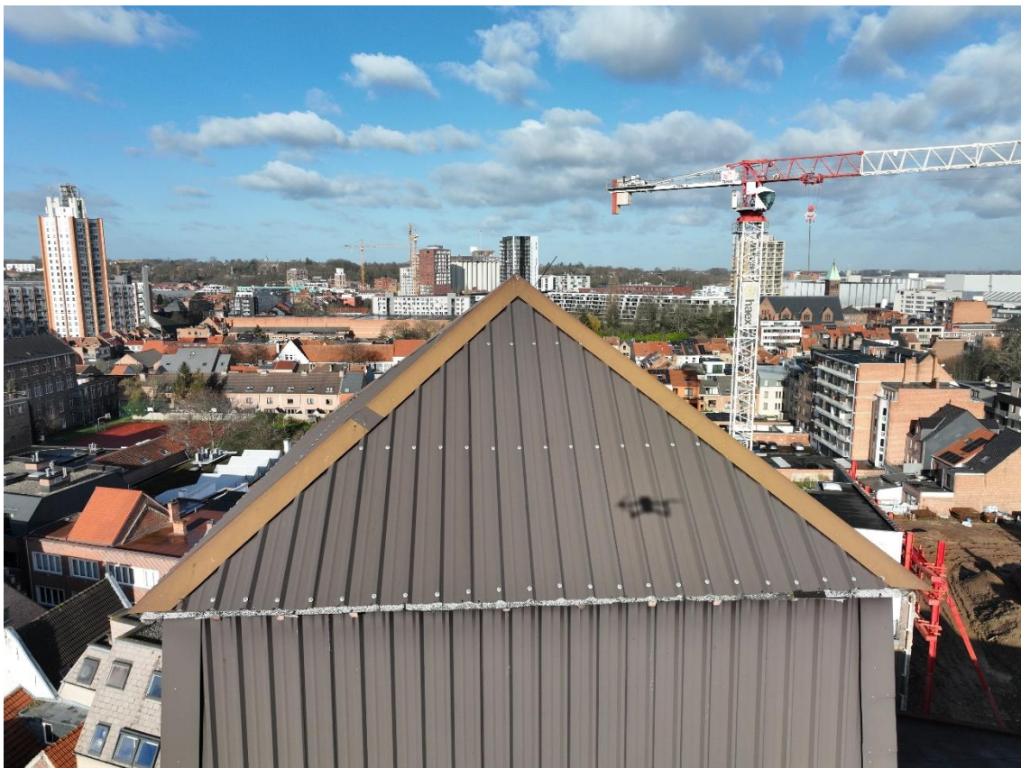
Foto 7: de toren versmalt naar boven toe en is afgedekt met een zwak hellend, licht overkragend piramidedak (rapport Monumentenwacht, dronebeeld Wim Meers, plaatsbezoek 30.01.2023, © Monumentenwacht).
