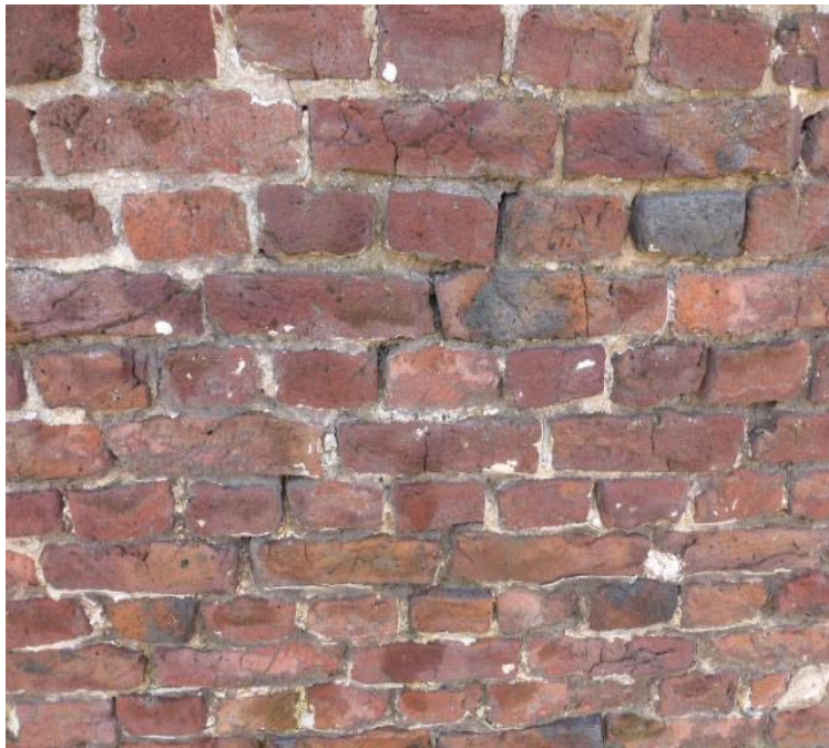
Foto 8: Schadebeeld metselwerk (Agentschap OE)
