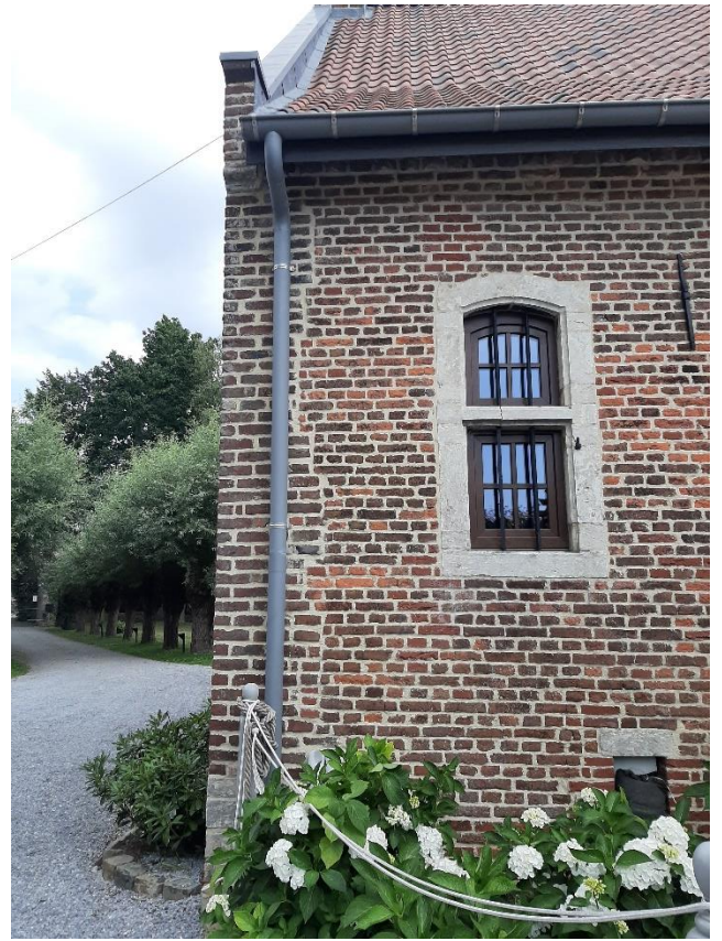
Foto 6: bouwnaad vanwege de heropgebouwde zijgevels.
