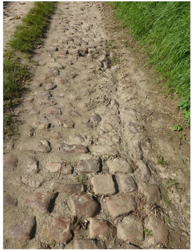
Foto 6: Zone met kasseien die uit verband zijn geraakt.
