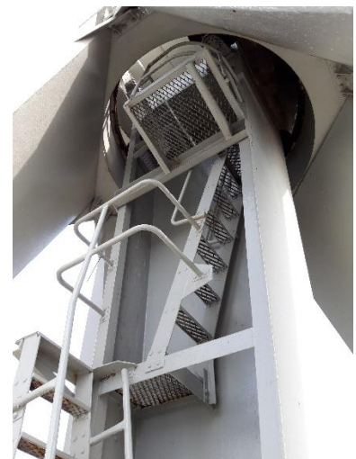
Foto 15: Trap naar de machinekamer en stuurcabine (14.10.2021).
