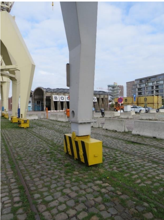
Foto 8: Portaalpoot met bogie (landzijde) (14.10.2021).
