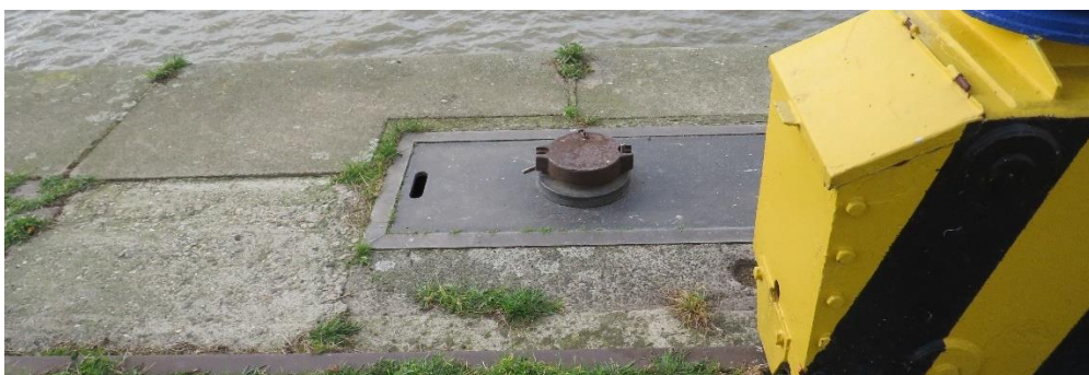
Foto 10: In de kade ingewerkt voeding voor elektrische aandrijving van de kraan (14.10.2021).
