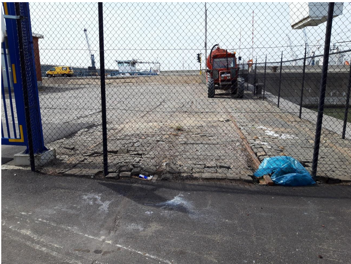
Foto 2: Foto van de deels geasfalteerde, deels gecorrodeerde sporen van de (naar de Rijnkaai overgebrachte) elektrische kraan nr. 371 JA aan de Wijnweg zonder nummer, 12.04.2022 (bron: archief Onroerend Erfgoed, foto genomen door Martijn Kivit)
