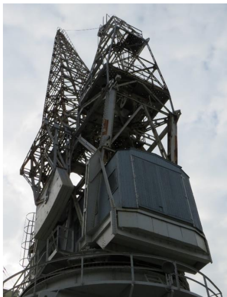
Foto 23: Zicht op machinekamer, giek en tegengiek (14.10.2021).
