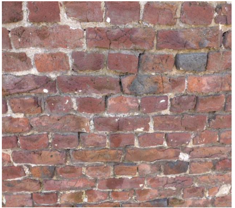
Foto 8: Schadebeeld metselwerk (Agentschap OE)
