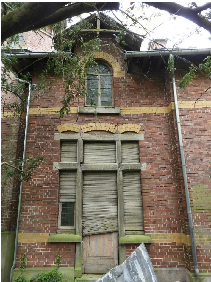
Foto 25: Washuis, scheuren in de gevel H. Verboven, 25 april 2022
