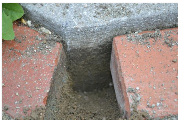
Foto 16: detail sokkel te diep geplaatst
