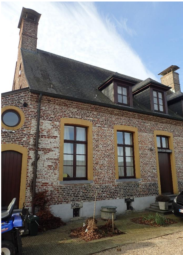
Foto 5: Gerenoveerde voor- of oostgevel van de Oude Pastorie – sporen vroegere kaleilagen (10.02.2023).
