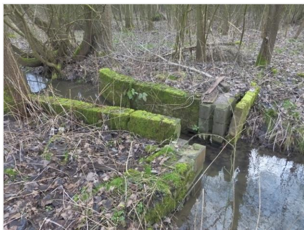
Foto 13: Stuw op de bovensloot in de watering.
