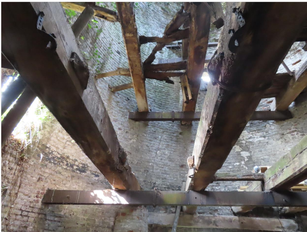
Foto 7: binnenzijde molenromp: resterende gestutte moerbalken (Monumentenwacht)
