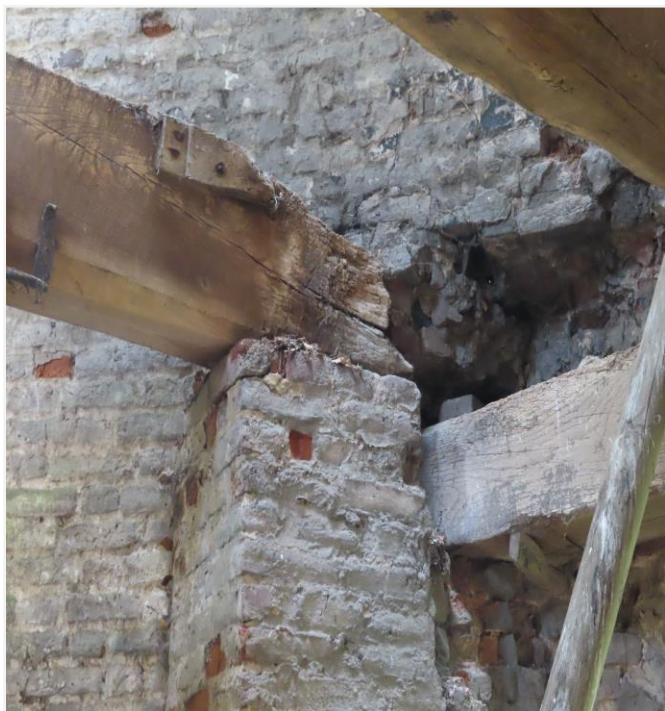
Foto 9: voorbeeld van rottende balkkoppen (Monumentenwacht)
