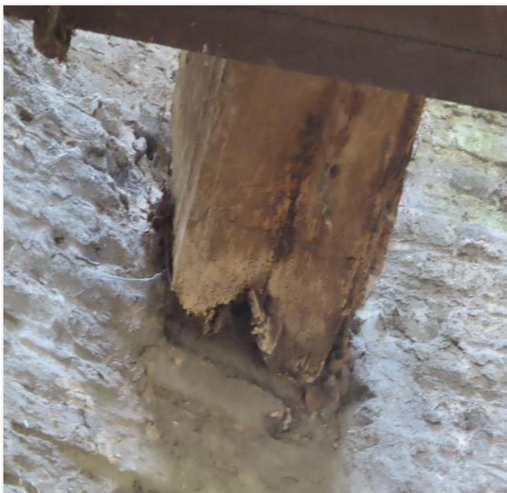
Foto 10: voorbeeld van rottende balkkoppen (Monumentenwacht)
