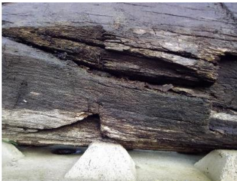
Foto 3: Het in slechte toestand verkerende restant van de standaard, het enige overgebleven molenonderdeel (© Monumentenwacht West-Vlaanderen, 15.01.2020).
