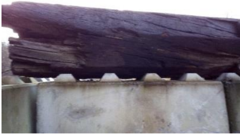
Foto 1: Het in slechte toestand verkerende restant van de standaard, het enige overgebleven molenonderdeel (© Monumentenwacht West-Vlaanderen, 15.01.2020).
