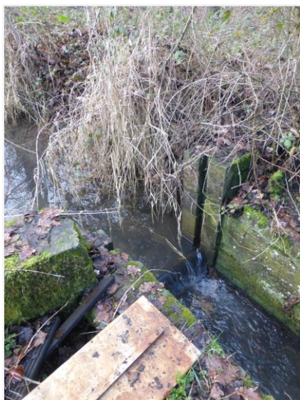
Foto 6: Stuw op de bovensloot in de watering.
