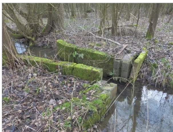
Foto 15: Stuw op de bovensloot in de watering.
