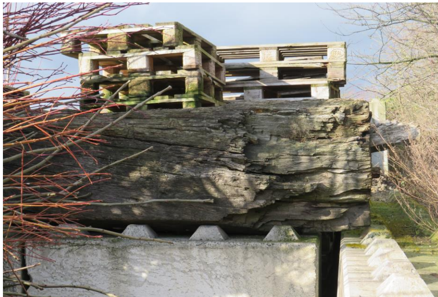
Foto 5: Het in slechte toestand verkerende restant van de standaard, het enige overgebleven molenonderdeel. Bewaard bij de Technische Loods van de Gemeente Ledegem in Rollegem-Kapelle (© Onroerend Erfgoed, 09.02.2022).
