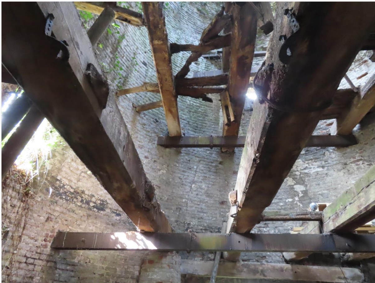
Foto 7: binnenzijde molenromp: resterende gestutte moerbalken (Monumentenwacht)
