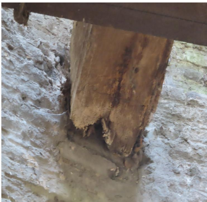
Foto 10: voorbeeld van rottende balkkoppen (Monumentenwacht)
