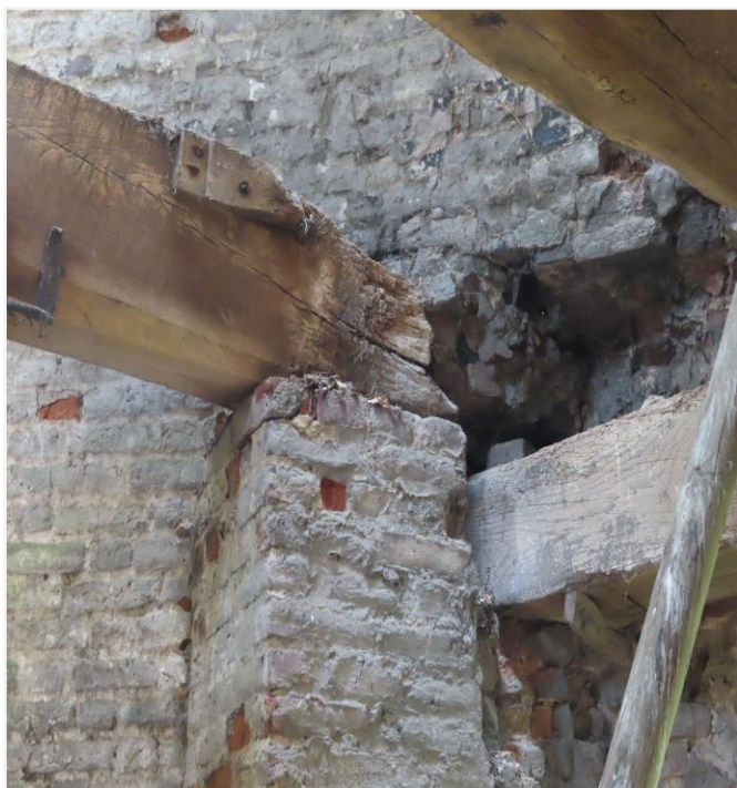
Foto 9: voorbeeld van rottende balkkoppen (Monumentenwacht)
