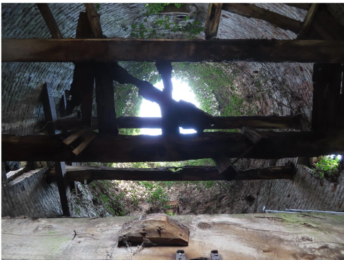
Foto 8: binnenzijde molenromp: open bovenzijde en resterende gestutte moerbalken (Monumentenwacht)
