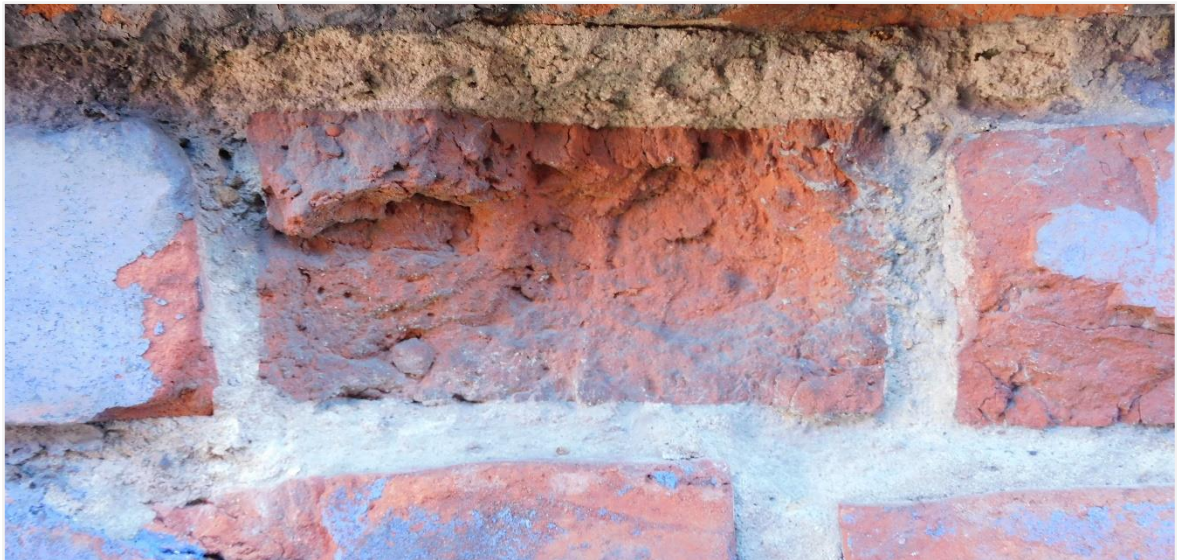
Foto 13: Detail beschadigingen bakstenen parement en verflaag Reclamemuurschildering Cigarettes Marouf Prinses Clementinalaan 205-213 (Monumentenwacht Vlaanderen 23 april 2021)
