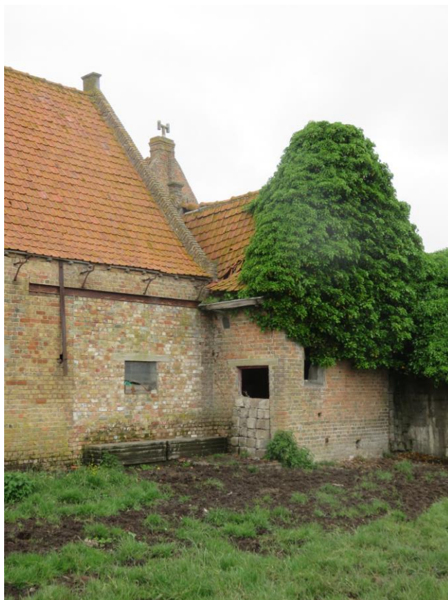
Foto 40. Het deels ingestorte dak van de stierenstal tussen twee bewaarde zijgevels (25.06.2021).
