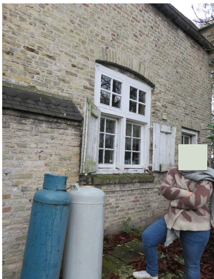
Foto 76: overgang van kook- & bakplaats naar keuken (oostelijke langsgevels) – uitbuiking ter hoogte van bakoven, leien lessenaarsdakje (14.11.2019).
