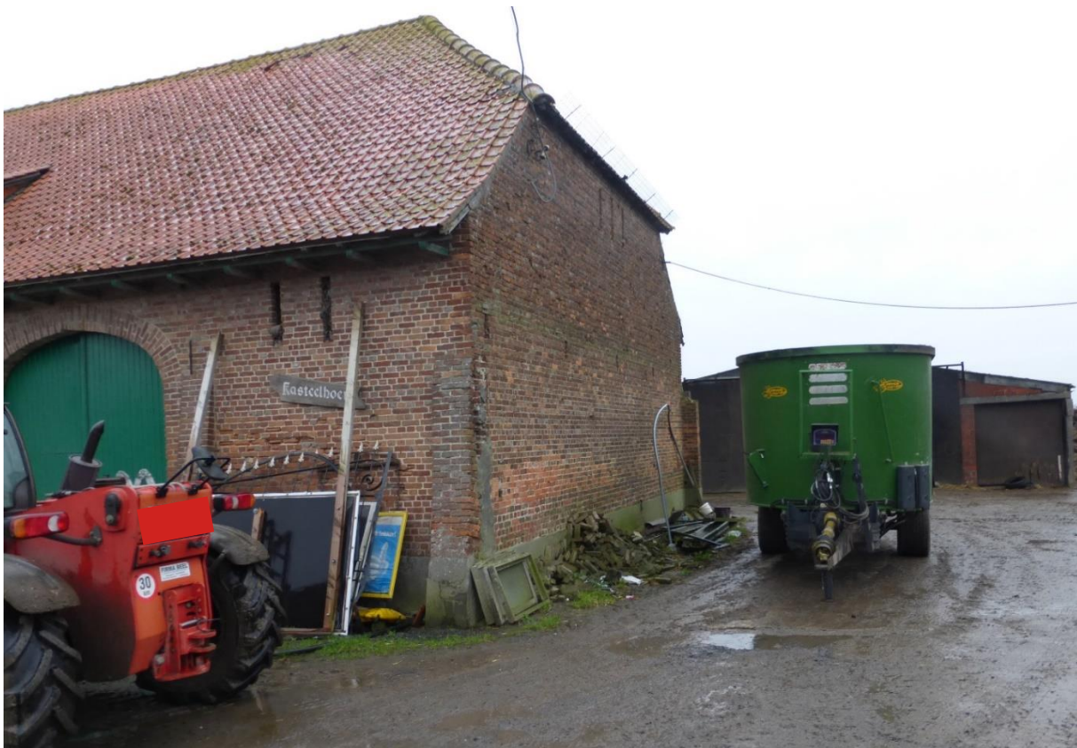
Foto 96: blinde rechter of noordelijke zijgevel met wolfseind - steunberen deels afgebroken ten gevolge van (intussen verdwenen) latere aanbouw onder lessenaarsdak - verticale verluchtungspleuven onder het wolfseind (28.02.2020).
