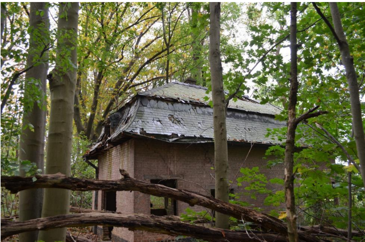
Foto 49: zicht op de zuidwestgevel van de belvédère, op steilrand aan de rand van het bosgedeelte van het Groot park; lacunes in het dak en ontbrekend schrijnwerk in de muuropeningen
