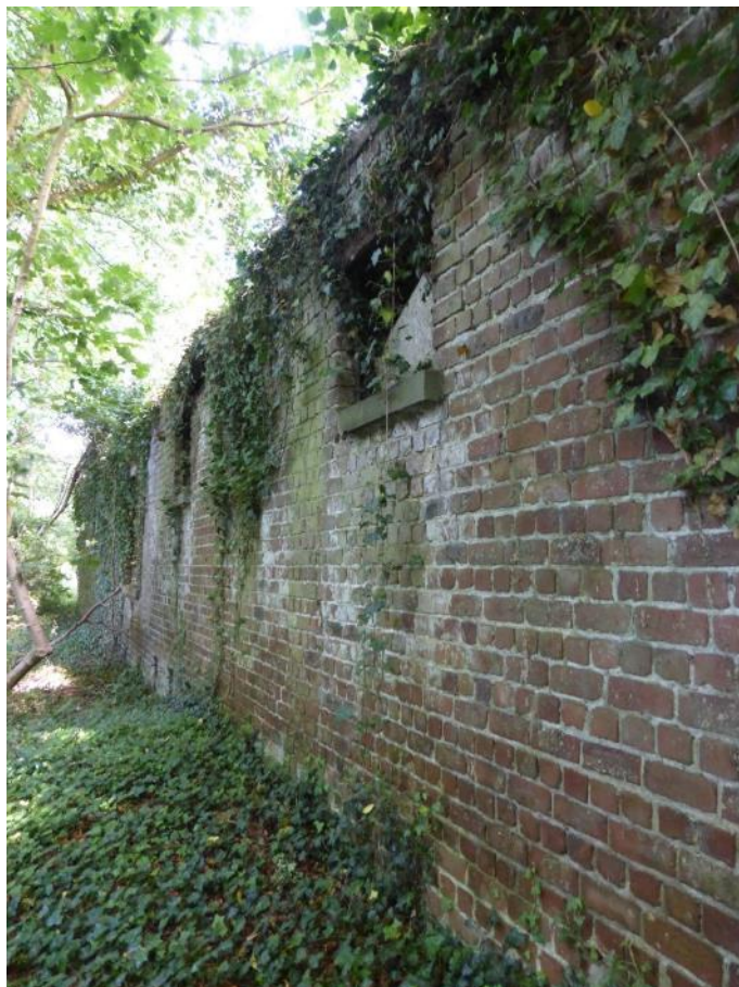
Foto 60: westelijke gevelzijde van het vervallen dienstgebouw bij de loods
