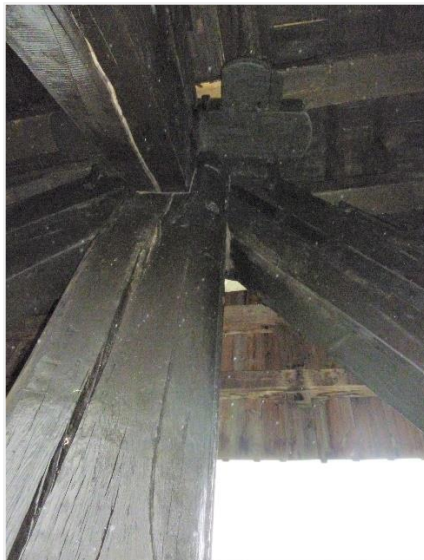
Foto 7: onderzijde molenkast verbinding steekbalken en zetel
