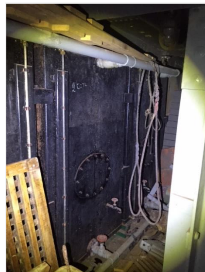
Foto 48: 1 van de 8 opslagtanks in de tankruimte (©MPM 2017)
