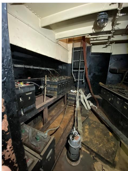
Foto 40: batterijruimte naast machinekamer
