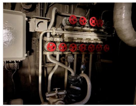
Foto 33: brandstofpomp met filter
