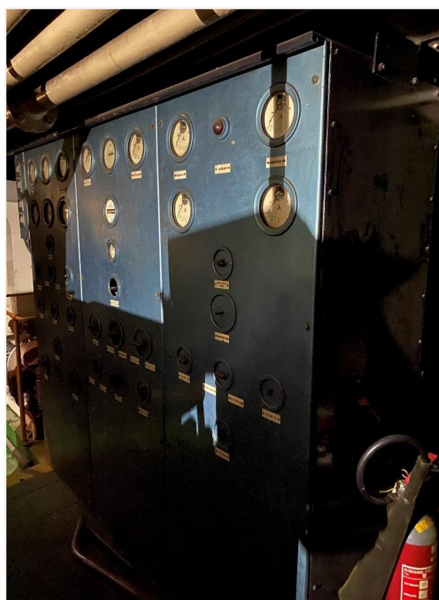
Foto 30: groot schakelbord machinekamer
