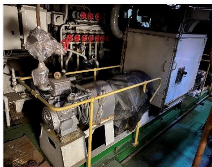
Foto 31: stroomgenerator groep 1: diesel met dynamo en compressor
