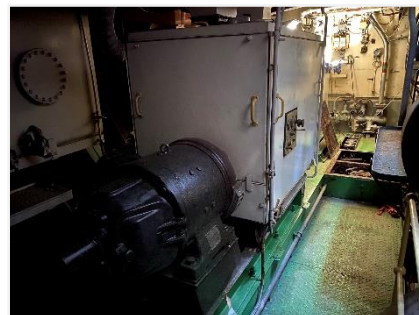
Foto 28: stroomgenerator groep 2 en 3, dieselmotor met dynamo
