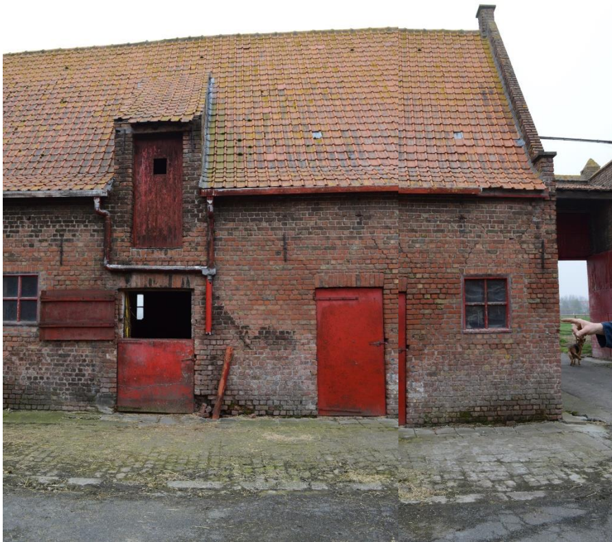
Foto 18. Stal ten zuiden van de toegangspoort. Hier is de oorspronkelijke goot niet bewaard, maar vervangen door een hanggoot (de ijzeren haken zijn verwijderd uit het metselwerk). Deels bewaarde bakstenen stoep (12.04.2018).
