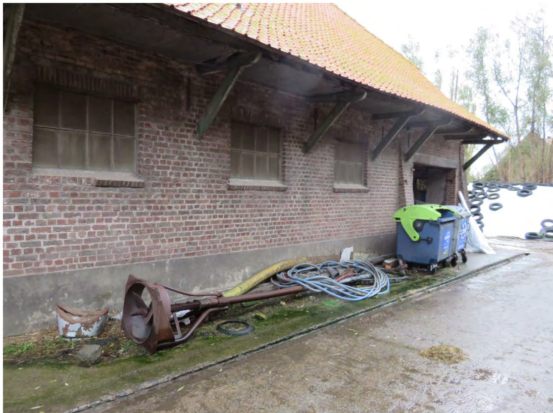
Foto 93: westelijke langsgevel of de achtergevel van de stal- en schuurvleugel – cementering - brede dakoverstek op houten modillons en korbelen ter hoogte van het stalgedeelte – vernieuwde invulling stalramen zonder erfgoedwaarde (14.11.2019).
