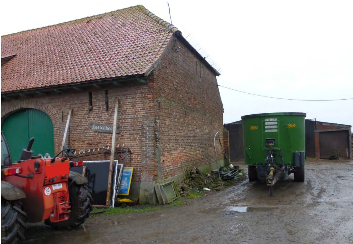
Foto 96: blinde rechter of noordelijke zijgevel met wolfseind - steunberen deels afgebroken ten gevolge van (intussen verdwenen) latere aanbouw onder lessenaarsdak - verticale verluchtingsgleuven onder het wolfseind (28.02.2020).
