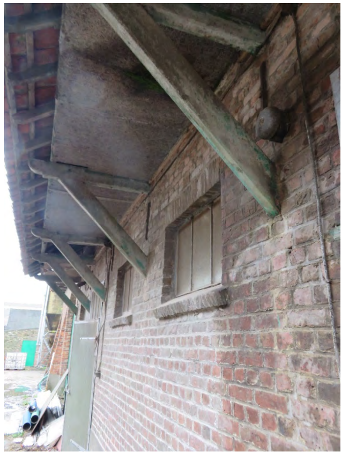
Foto 95: brede dakoverstek met houten modillons en korbelen - vernieuwde invulling stalramen en -deur zonder erfgoedwaarde (14.11.2019).
