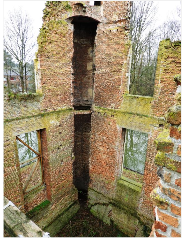
Foto 18: binnenzicht in de ruïne van de zuidvleugel (westzijde).
