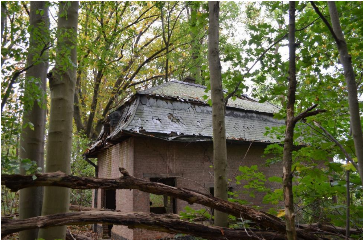
Foto 49: zicht op de zuidwestgevel van de belvédère, staande op steilrand aan de rand van het bosgedeelte van het Groot park; lacunes in het dak en ontbrekend schrijnwerk in de muuropeningen.
