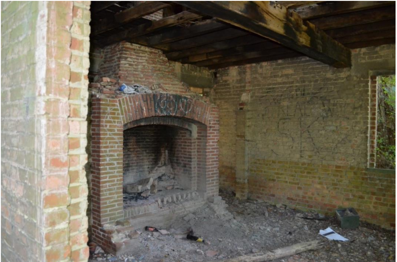
Foto 50: zicht vanuit het noorden op de open haard in de voorkamer of 'salon' van de belvédère of het jachtpaviljoen; toestand na een vermoedelijke schouwbrand; en ontbrekend schrijnwerk in de muuropeningen.
