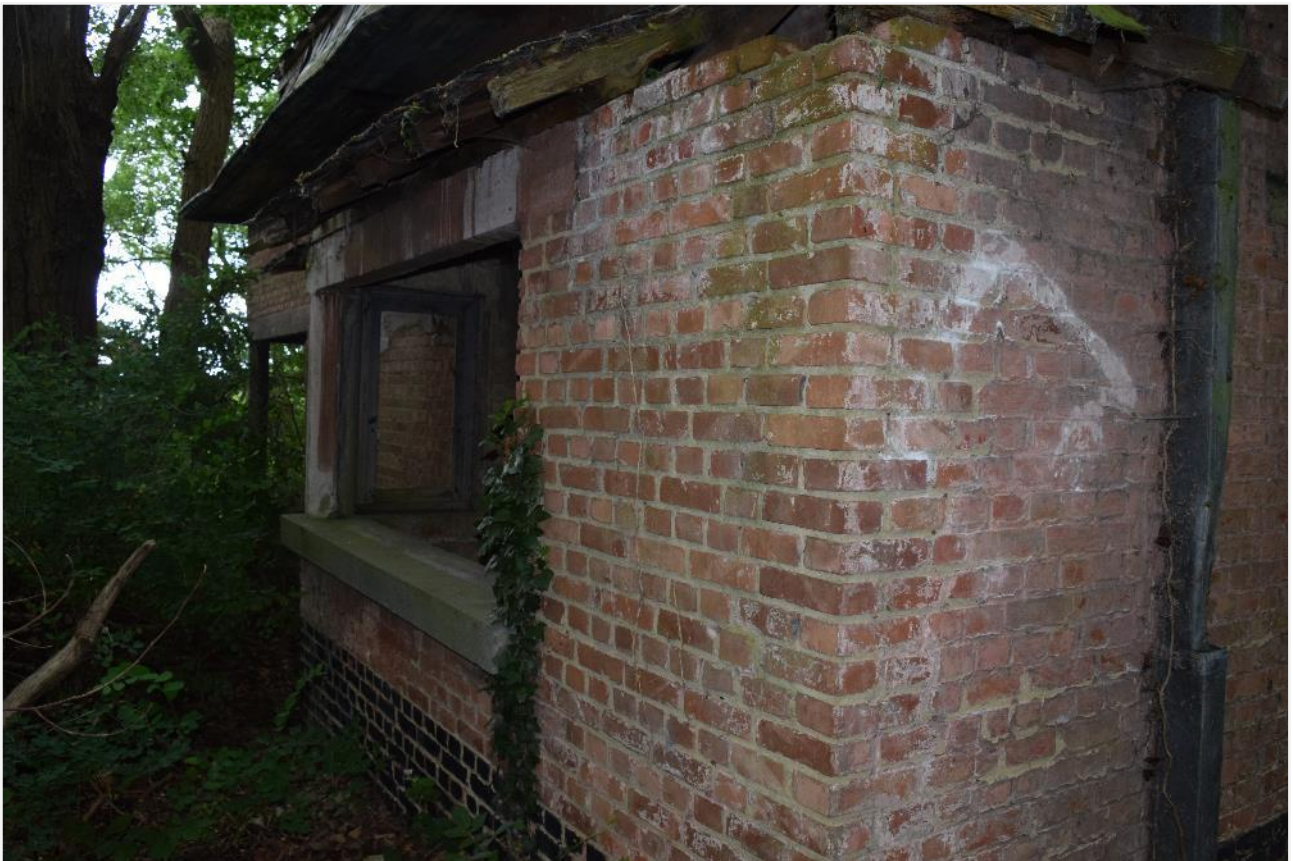
Foto 54: Belvédère: zijgevel zwarte plint, roze verf
