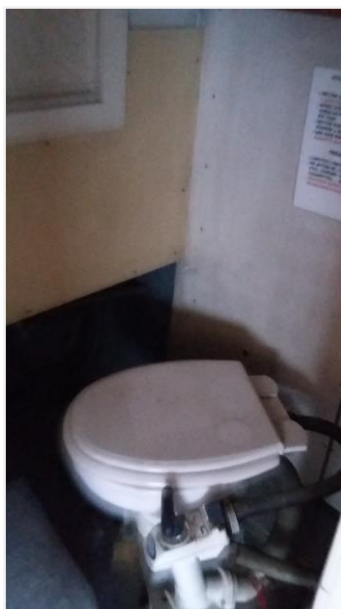
Foto 10: scheepstoilet tussen machinekamer en achterdek
