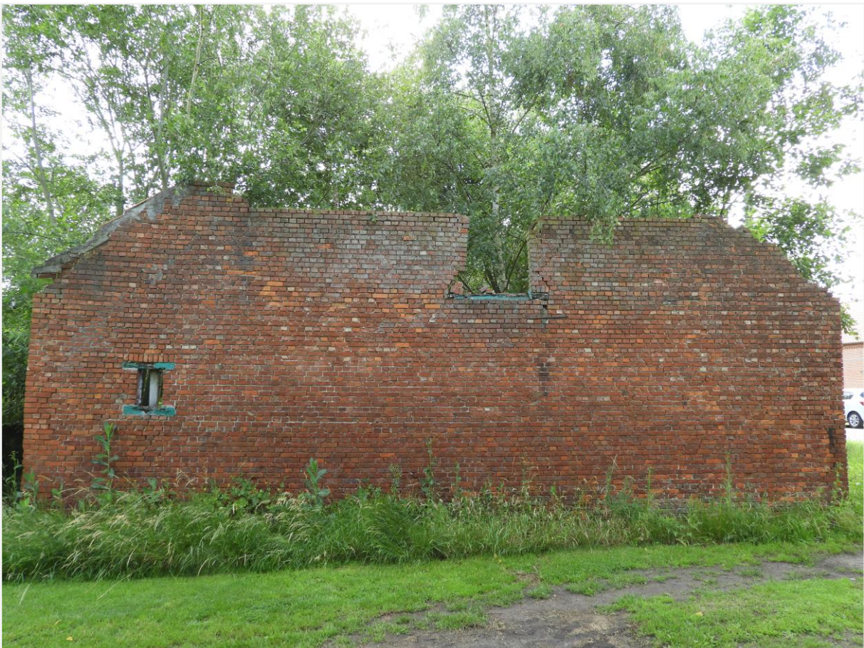
Foto 2: overblijfsel van de westelijke zijgevel van het hoevegebouw.
